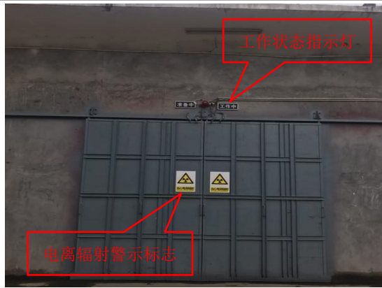
防护门外工作状态警示灯及警告标志
