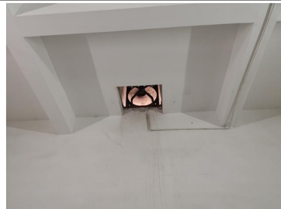
探伤室通风设施
