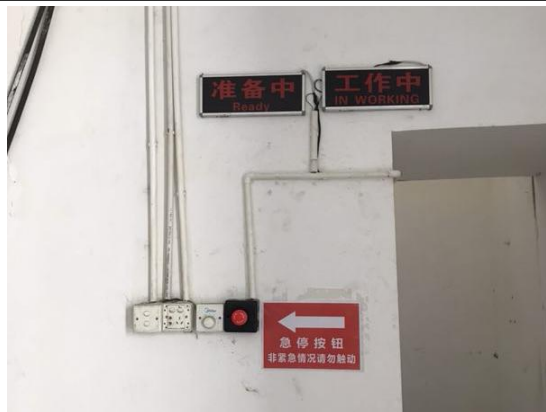
机房内急停按钮及工作状态指示灯
