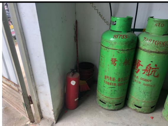
液化石油气存储间配备灭火器
