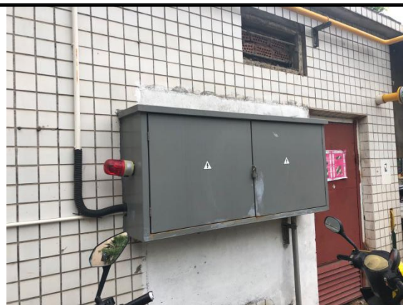
液化石油气存储间报警装置
